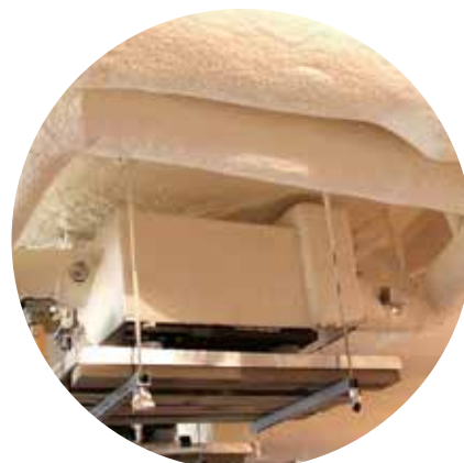
Canale pentru tubulaturi HVAC
